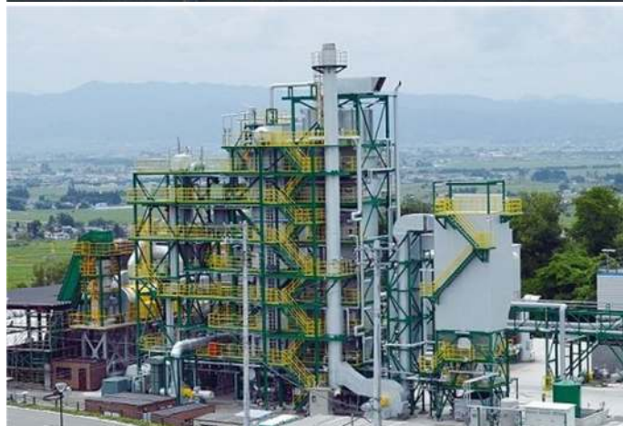
大都市のど真ん中で稼働した川崎バイオマス発電(株)の川崎バイオマス発電所(33MW)(上)と、FIT制度設計のモデルになった(株)グリーン発電会津の河東発電所(5.8MW)
